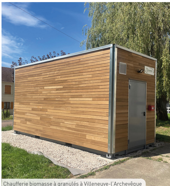
Chaufferie biomasse à granulés à Villeneuve-l'Archevêque
